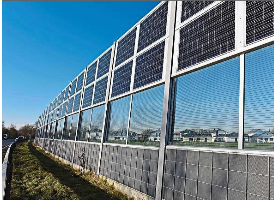
Die PV-Lärmschutzwand in Neuötting an der alten B 12 hat sich bewährt. Darum nennt sie MdL Martin Huber als Beispiel für gelungenen Lärmschutz, mit dem man auch Strom erzeugen kann. – Foto: Richter
